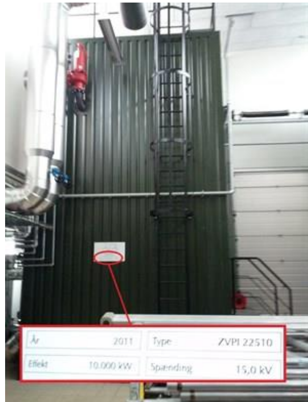
10 MW Elektrodenkessel im neuen Betriebsgebäude
