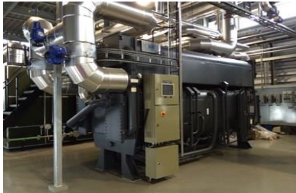
Absorptionswärmepumpe, angetrieben vom Abgas des Erdgaskessels. Im Ergebnis haben Kessel und Wärmepumpe zusammen einen Wirkungsgrad von 109% (Ramboll).
